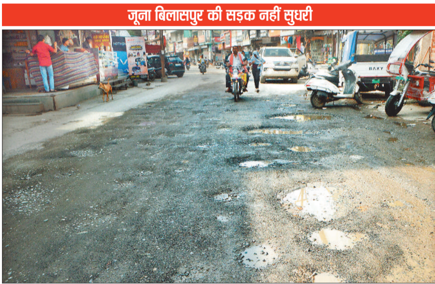
जून बिलासपुर की जर्जर सड़क।
